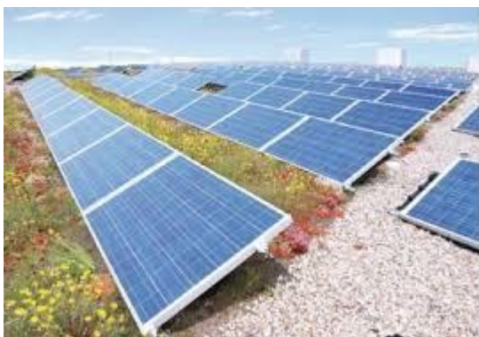
PV-panels op groendak (afbeelding: architectura.be)
