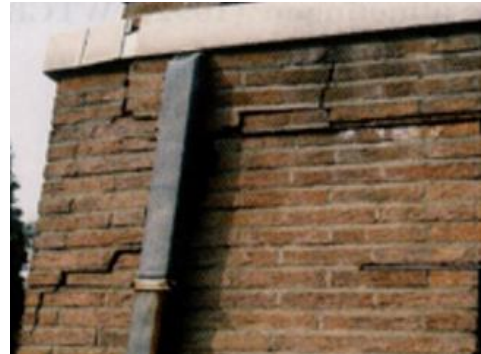
Scheurvorming ter hoogte van de aansluiting tussen dak en wanden (foto: dialoog vzw)
