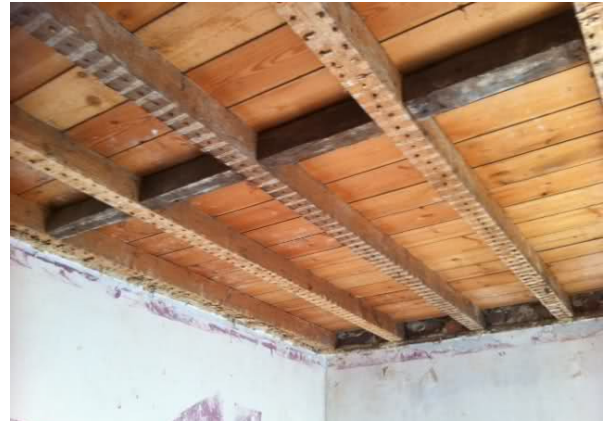
Zoldervloer zonder afwerking aan de onderzijde: geschikt voor isolatie tussen de draagstructuur (foto: Bouwinfo)
