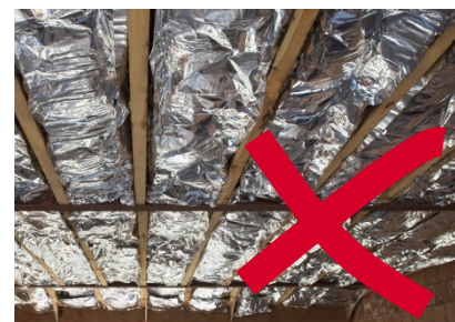
Zoldervloerisolatie met flensdeken: verkeerde plaatsing (foto: Shutterstock)
