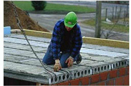
Massieve vloer met welfsels, open naar de spouwmuur (Foto: Livios)
