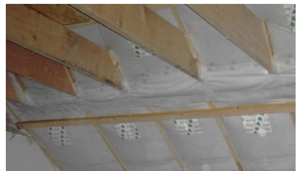
Spantendak: doorboringen van het luchtscherm ter hoogte van de trek balken (Foto: E-advies)
