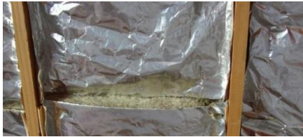
Verkeerde plaatsing van flensdeks (foto: Rockwool)
