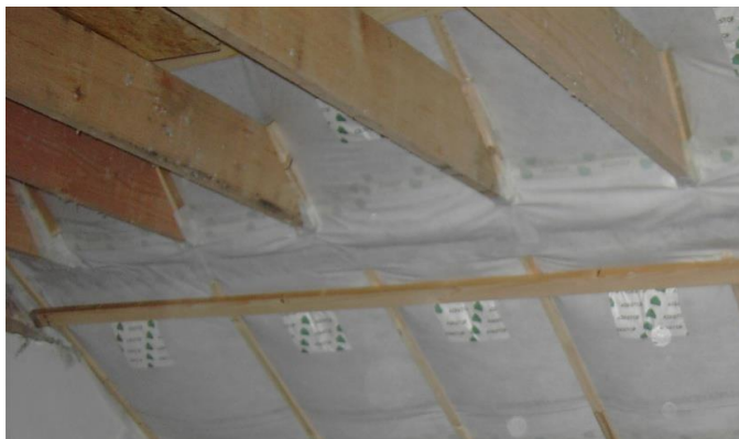
Spantendak: doorboringen van het luchtscherm ter hoogte van de trekbalen (Foto: E-advies)
