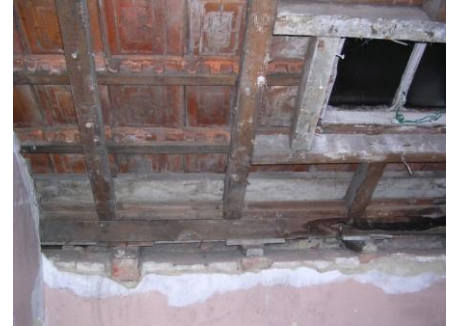
Houtwerk in slechte staat (Foto: E. Willaert)
