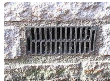
Verluchtingsrooster in spouwmuur (foto: Wikipedia)
