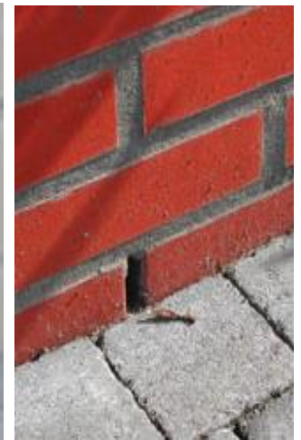
Buitenverharding te hoog geplaatst, waardoor open stootvoegen onderaan gedicht zijn (foto: WTCB)
