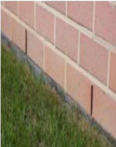
Stootvoegen, geopend tot op de onderliggende waterkering. De waterkering zou lichtjes uit de muur moeten steken. (foto: WTCB)
