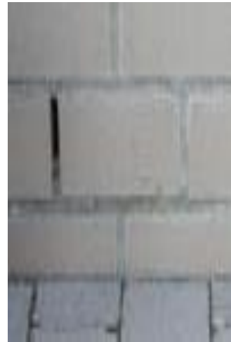
Stootvoegen niet open tot op de waterkering (foto: WTCB)
