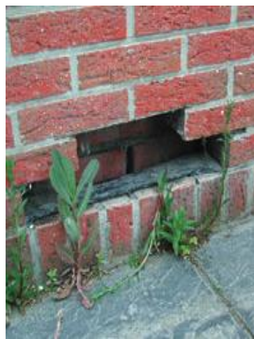
Verkeerde plaatsing van de waterkering: niet omhooggeplooid. (foto: WTCB)
