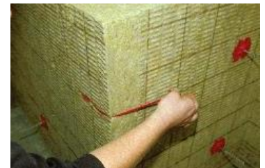
Openstaande hoeken vermijden bij minerale wol met hoekankers (foto: Rockwool)
